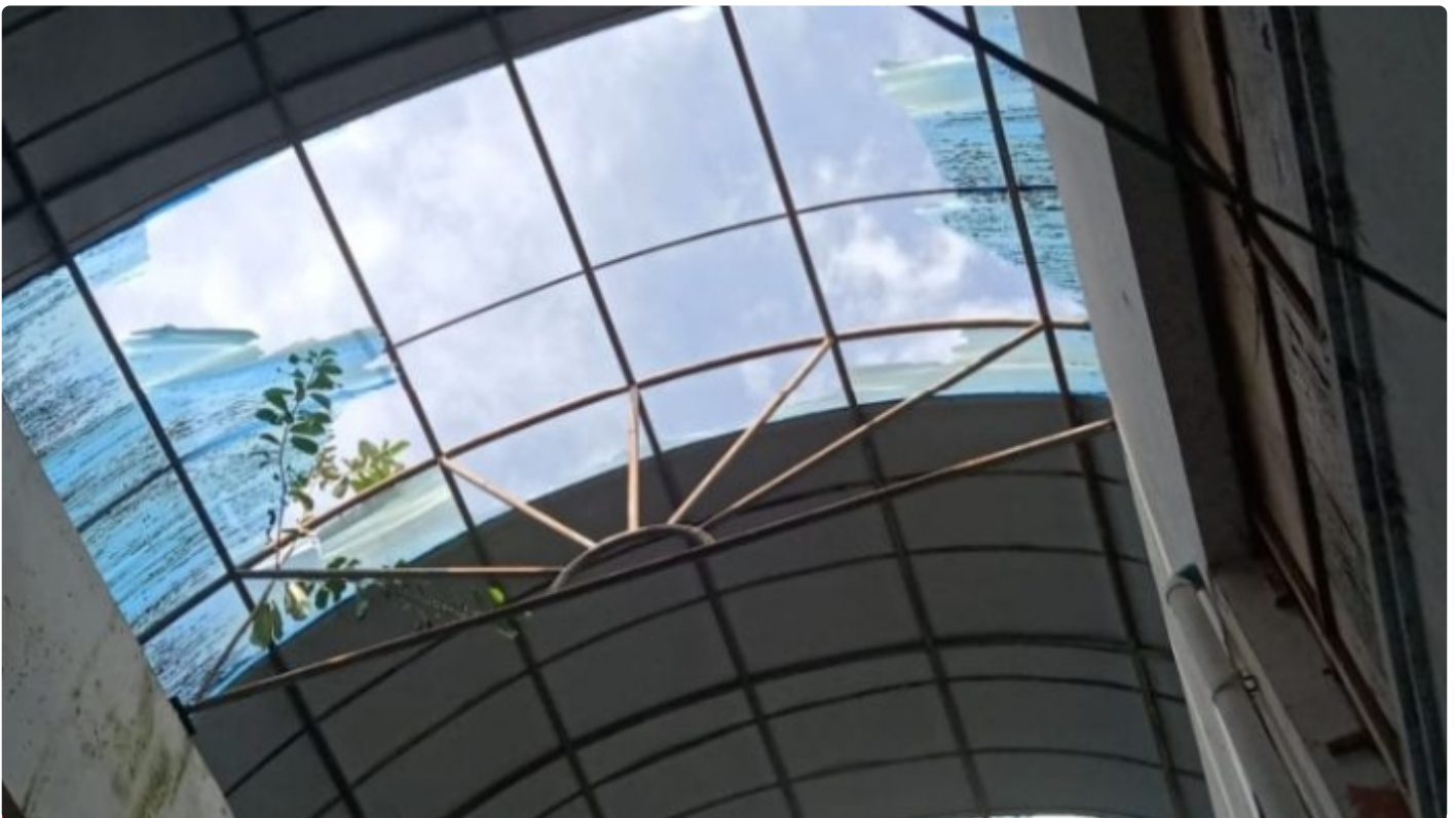
Nampak atap pasar Pekkae yang rusak mengakibatkan air hujan masuk ditengah pasar
